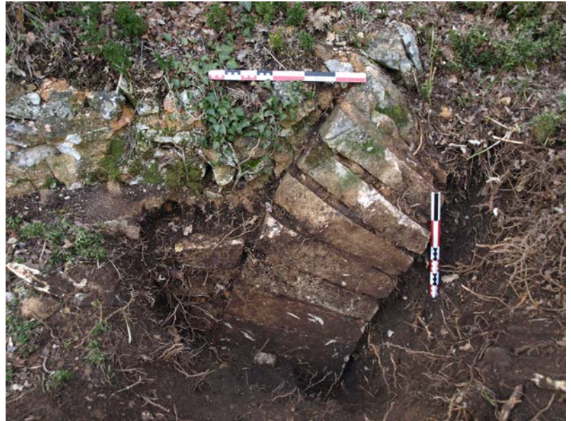
Figure 57 Départ de l'arc sur la culée aval, vue vers l'ouest. © V. Mialthe (SahCM)
