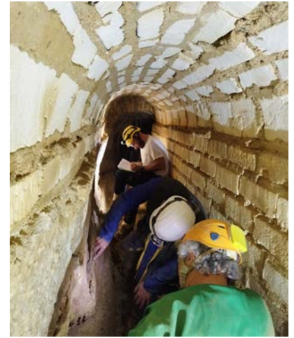
Figure 20 La section de chez Mr. Torregrossa, du tunnel du « Plantis des Neuf Puits », vue vers le sud. © R. Charrier (SahCM)
