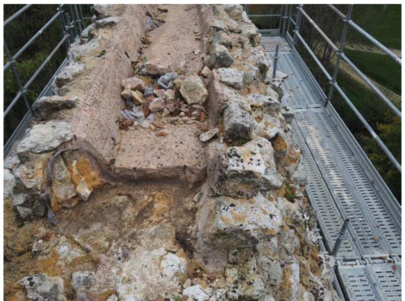
Figure 58 Restauration du conduit posée sur un géotextile et dessous, ancienne maçonnerie pouvant correspondre au canal de la phase III, vue vers le sud. © V. Mialthe (SahCM)
