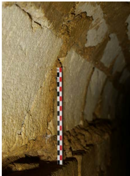
Figure 91 Courbure du bloc sommier de la voûte 1007, posé sur la maçonnerie 1005, vue vers le sud. © V. Mialhe (SahCM)
