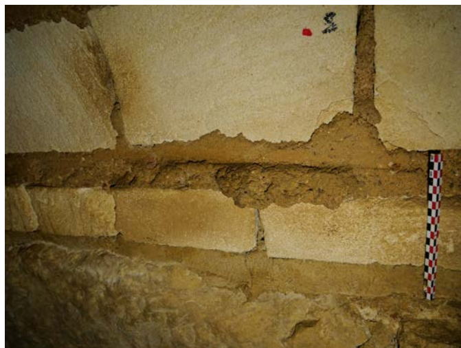
Figure 94 Négatif de planche correspondant à la base du vau, sous les sommiers de la voûte 1007. © V. Mialhe (SahCM)
