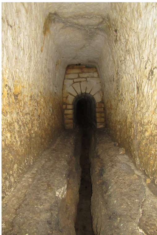
Figure 40 Tunnel au lieu-dit « la Foucherie », vue vers le nord. © J.-L. Hillairet (SahCM)
