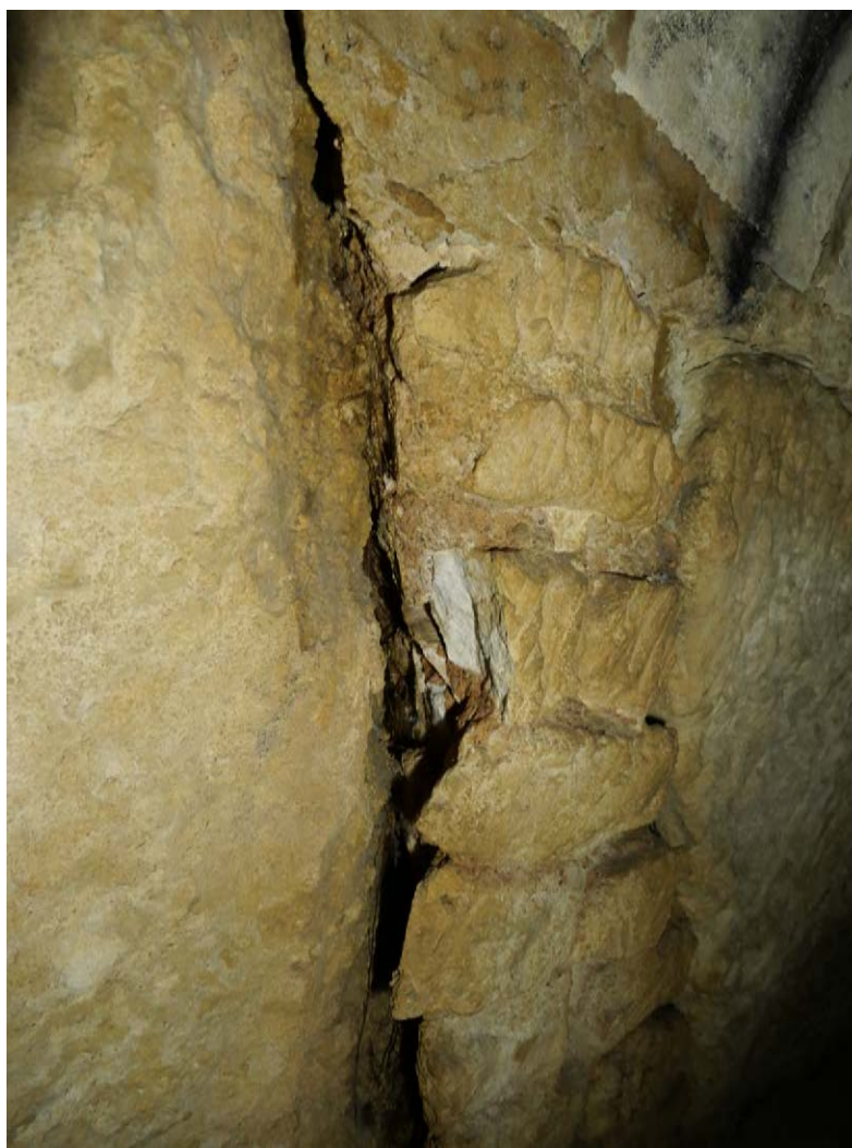
Figure 98 Le détachement de la maçonnerie 2013, scellant une diaclase, vue vers le sud-est. © V. Mialhe (SahCM)
